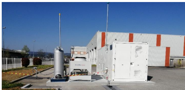
Station GNV du dépôt de Keolis Drôme Ardèche – Portes-Lès-Valence
